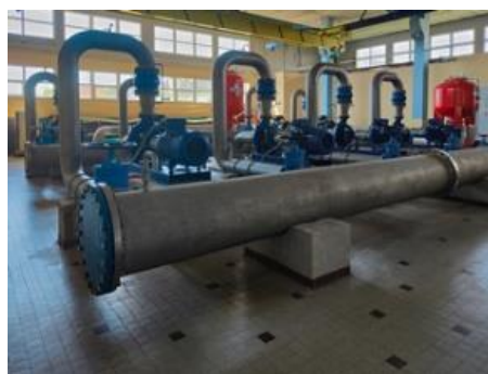
Figure 3 Pompes de distribution d'eau sur le réseau
