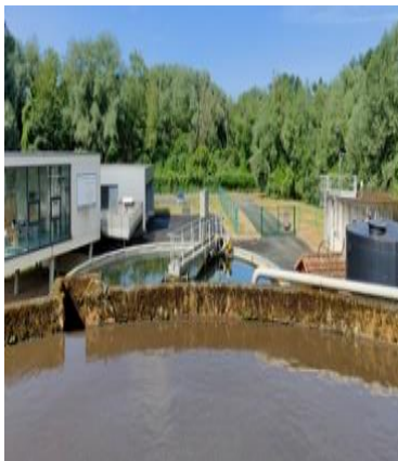
2 Bassin biologique avec l'écoulement du chlorosulfate ferrique en goutte à goutte
