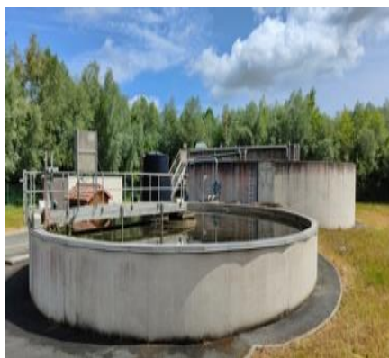
1 vue générale des 2 bassins
