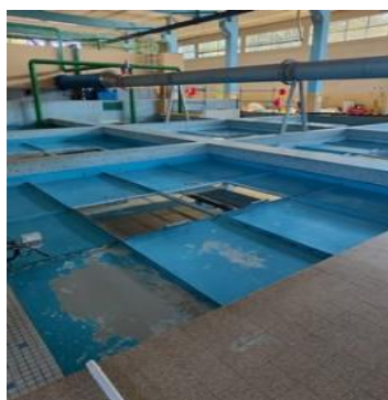
Figure 2 bassins de filtration
